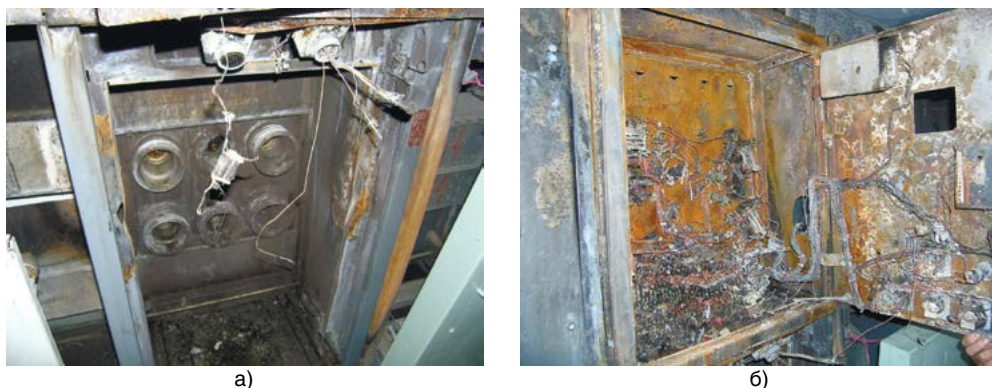
Рис. 1. Последствия дугового замыкания в ячейке КРУ-10кВ: а) масляные выключатели после дугового замыкания; б) релейный отсек КРУ.
