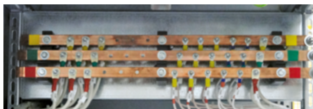
Подключение силовых цепей непосредственно к питающим шинопроводам
