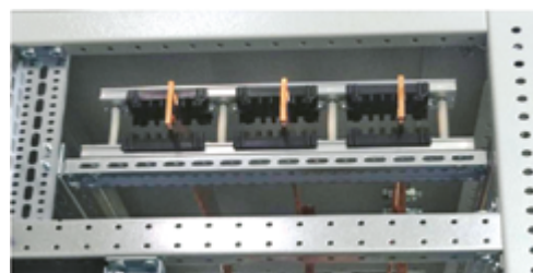
Отсек горизонтальных сборных шин
