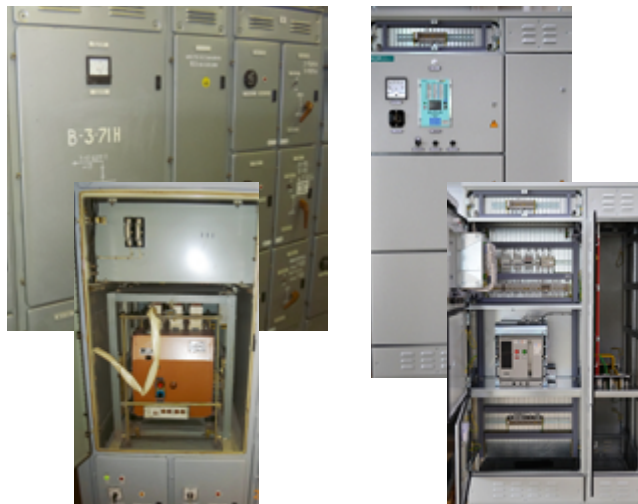
Замена отдельных шкафов ЩСН на новые с оснащением МП РЗА и мониторингом
