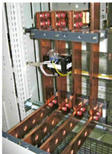
Узел подключения кабелем от ТСН
