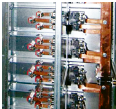
отводами из медных шин
