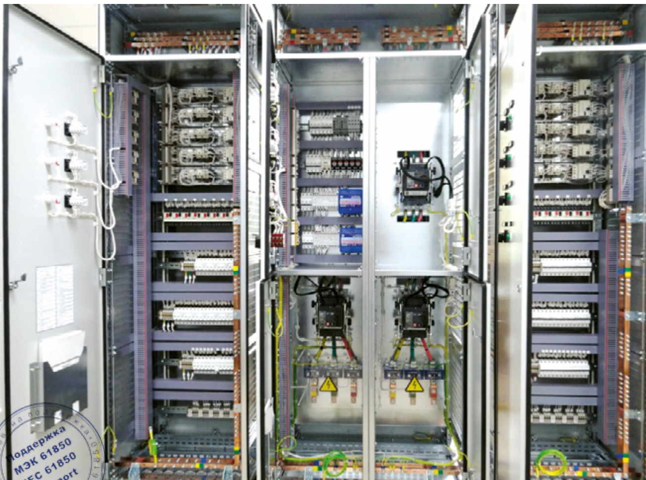
Щит системы НКУ-BS-СТ
