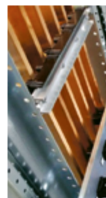
Отсек вертикальных распределительных шин
