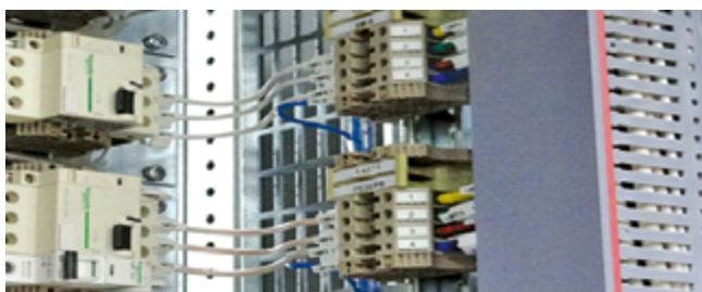
Подключение проводов вторичных цепей через клеммные зажимы
