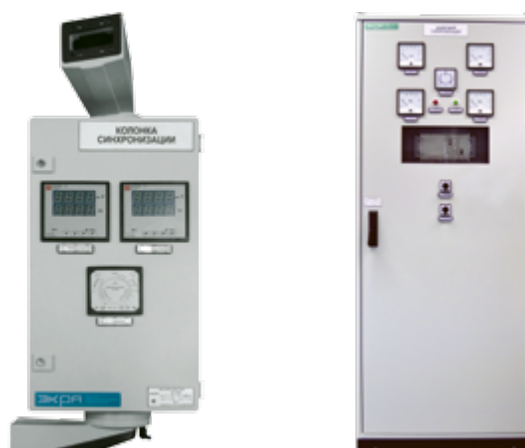
Колонка и шкаф синхронизации
