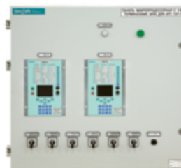
Дверь релейного отсека с терминалами ЭКРА 217
