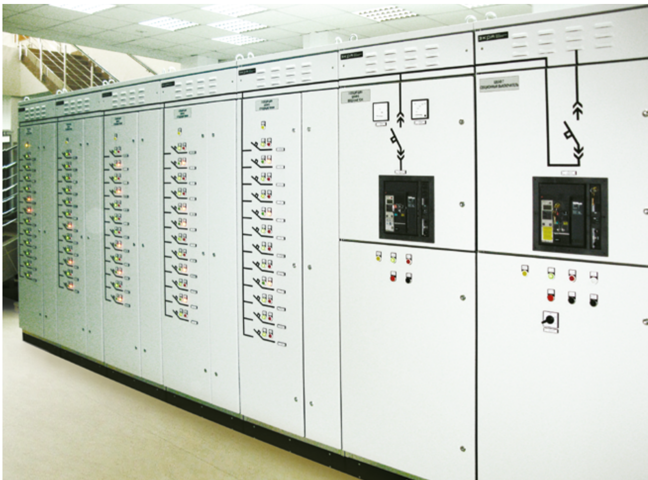
Щит собственных нужд переменного тока для подстанции 500 кВ, выполненный в сборном оцинкованном конструктиве
